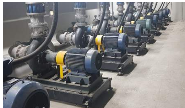
저효율 냉각수 펌프 개선
